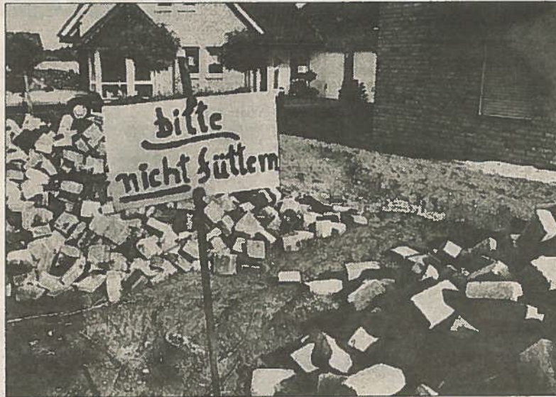
„Bitte nicht füttern“, steht groß auf einem Schild, das Rozet-Fotograf Johannes Kruck zwischen zwei Haufen von Pflastersteinen an einer Baustelle am Elsendeich in Kranenburg ablichtete. Da stellt sich natürlich die Frage, welche Art von „Verköstigung“ hier nicht erwünscht ist.
